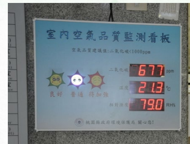
自動監測設備
