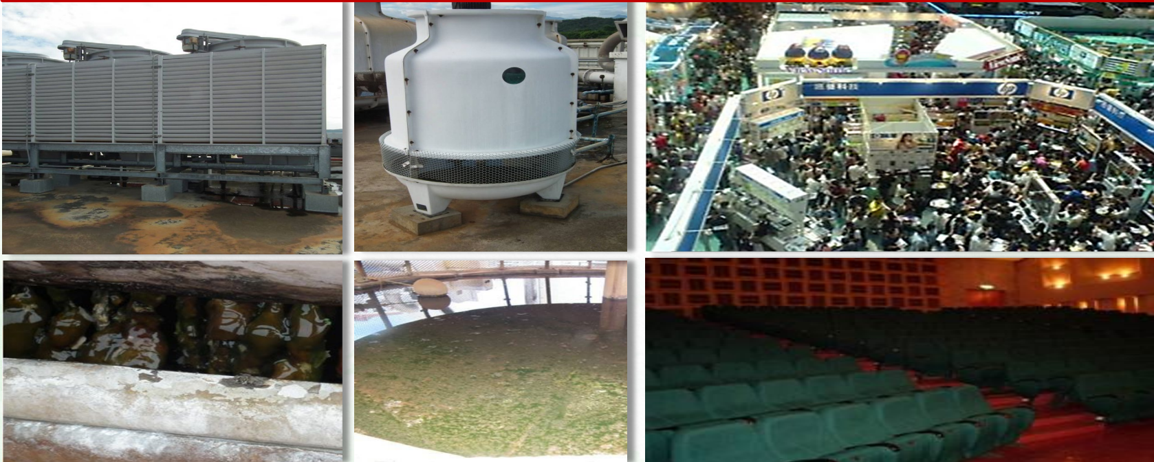
冷卻水塔之貯水池內藻類孳生情形
