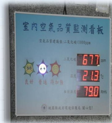
自動監測設備
